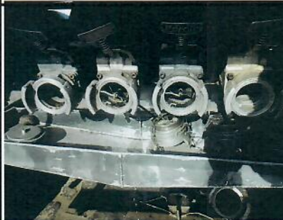
Détail vannes de dépotage
