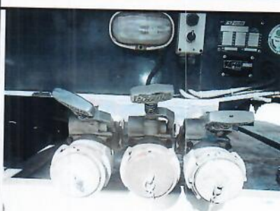
Détail vannes de dépotage
