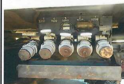
Détail vannes de dépotage
