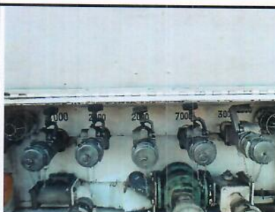
Détail vannes de dépotage
