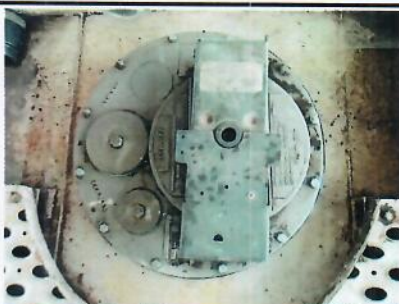
Détail trous dôme Contre visite du 06-10-25
