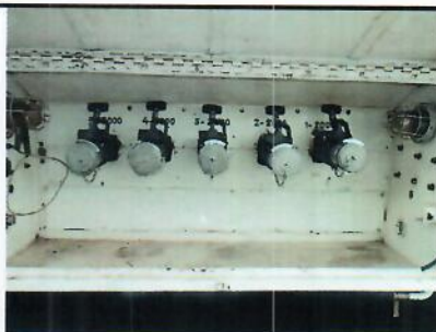
Détail vannes de dépotage
