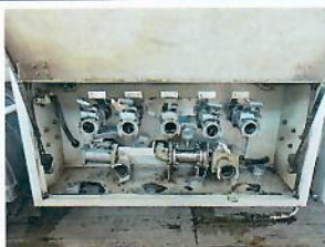
Vannes de dépotages
