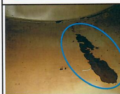
Détail intérieur brise flot dans Cpt n°5
