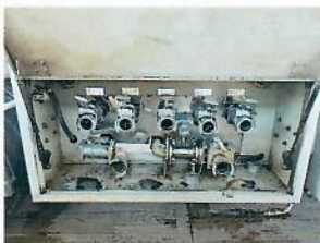
Vannes de dépotages
