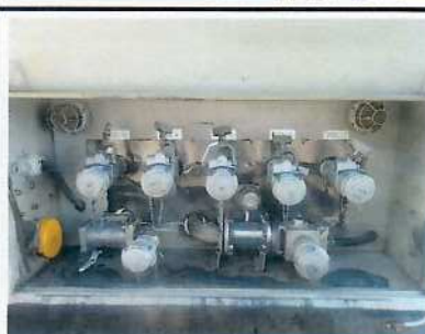
Détail vannes de dépotage
