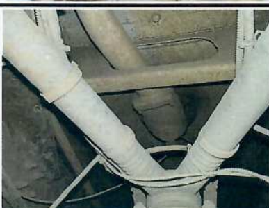
Détail clapet de fond
