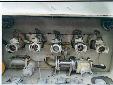
Détail vannes de dépotage
