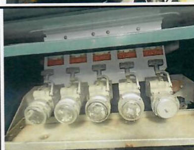
Détail vannes de dépotage
