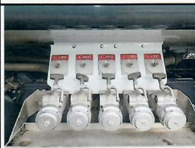
Détail vannes de dépotage
