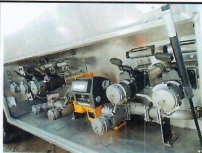
Détail vannes de dépotage
