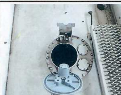
Détail vannes de dépotage
