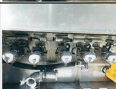
Détail vannes de dépotage
