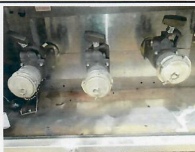
Détail vannes de dépotage
