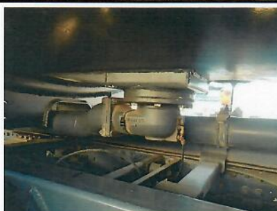
Détail clapet de fond
