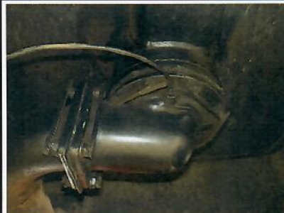
Détail clapet de fond
