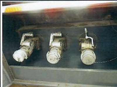
Détail vannes de dépotage
