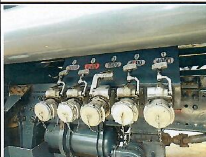
Détail vannes de dépotage
